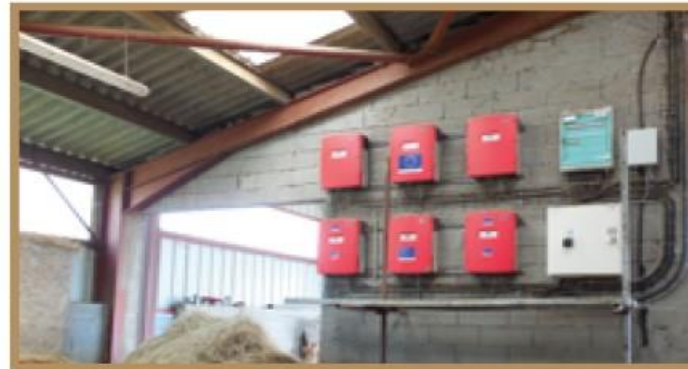
Onduleurs dans bâtiment
