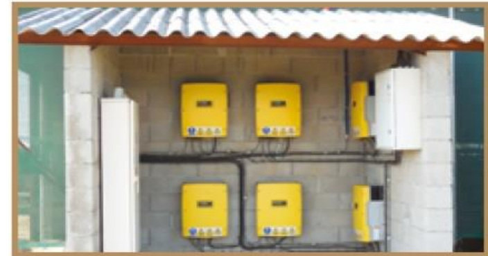
Onduleurs dans local hors du bâtiment
